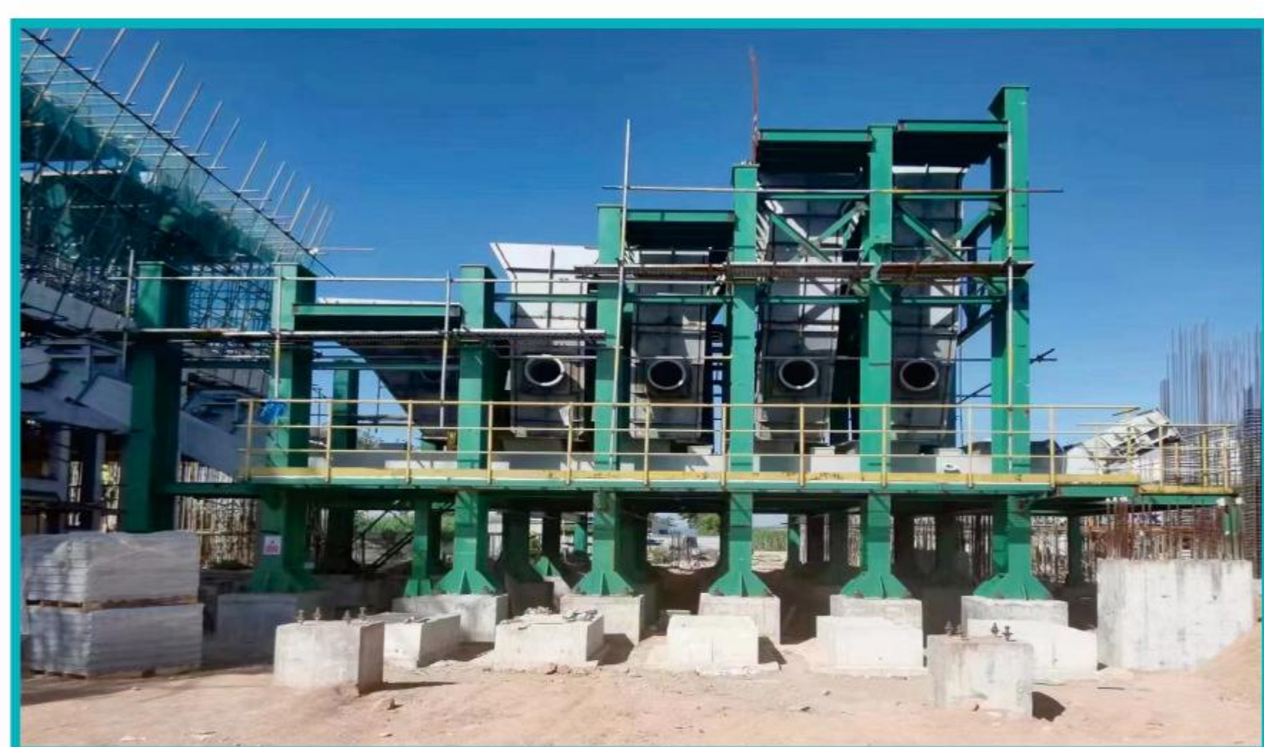
► 400tpd 泰国来兴府垃圾焚烧项目 ► 光大供货炉排炉+余热锅炉
